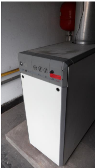
Figura 4.23 – Posizionamento generatore di calore tradizionale a basamento
