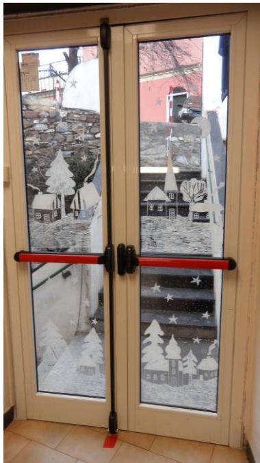
Figura 4.16 – Serramenti in alluminio e vetrocamera
