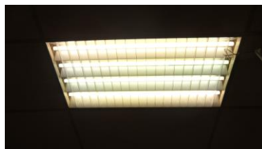
Figura 4.27 - Particolare dei corpi illuminanti ubicati nell'edificio- fluorescente 4X36W
